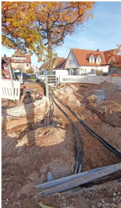
In Georgensgmünd (hier: Verknüpfungspunkt Pleinfelder Str. – Hammerweg) erfolgt ein stetiger Ausbau/Erweiterung des Niederspannungsnetzes
