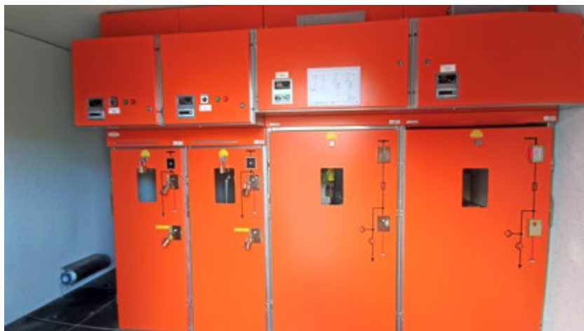
Eine Mittelspannungsschaltanlage in einer Übergabestation leitet den Strom – z.B. von PV-Anlagen - in das Stromnetz der Gemeindewerke Georgensgmünd
